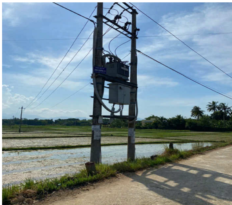
TRẠM BIẾN ÁP BÌNH CHƯƠNG 12
